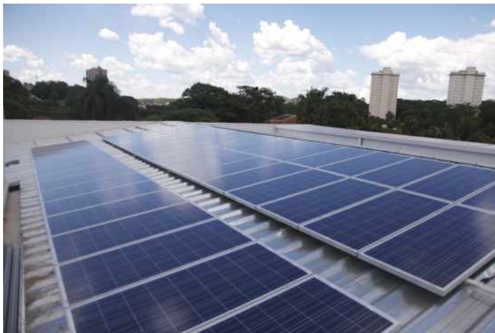
FIGURA 5.1 – Painéis solares feitos à base de Silício. Fonte: www.neosolar.com.br
